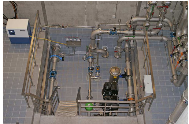
Abb. 3 Rohrleitungskeller mit Pumpstation
